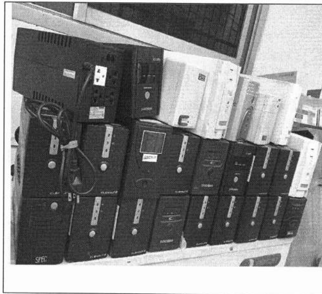
เครื่องควบคุมและสำรองกระแสไฟฟ้า
